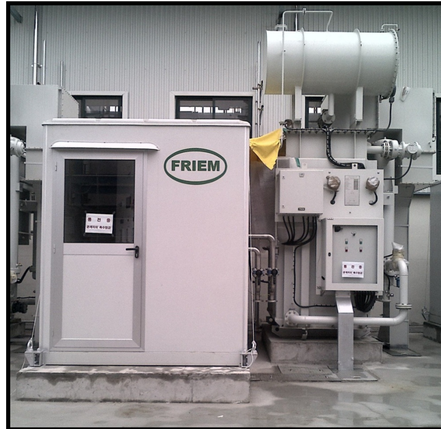
20kA-600V – Dupla ponte 12 pulsos Tiristor
